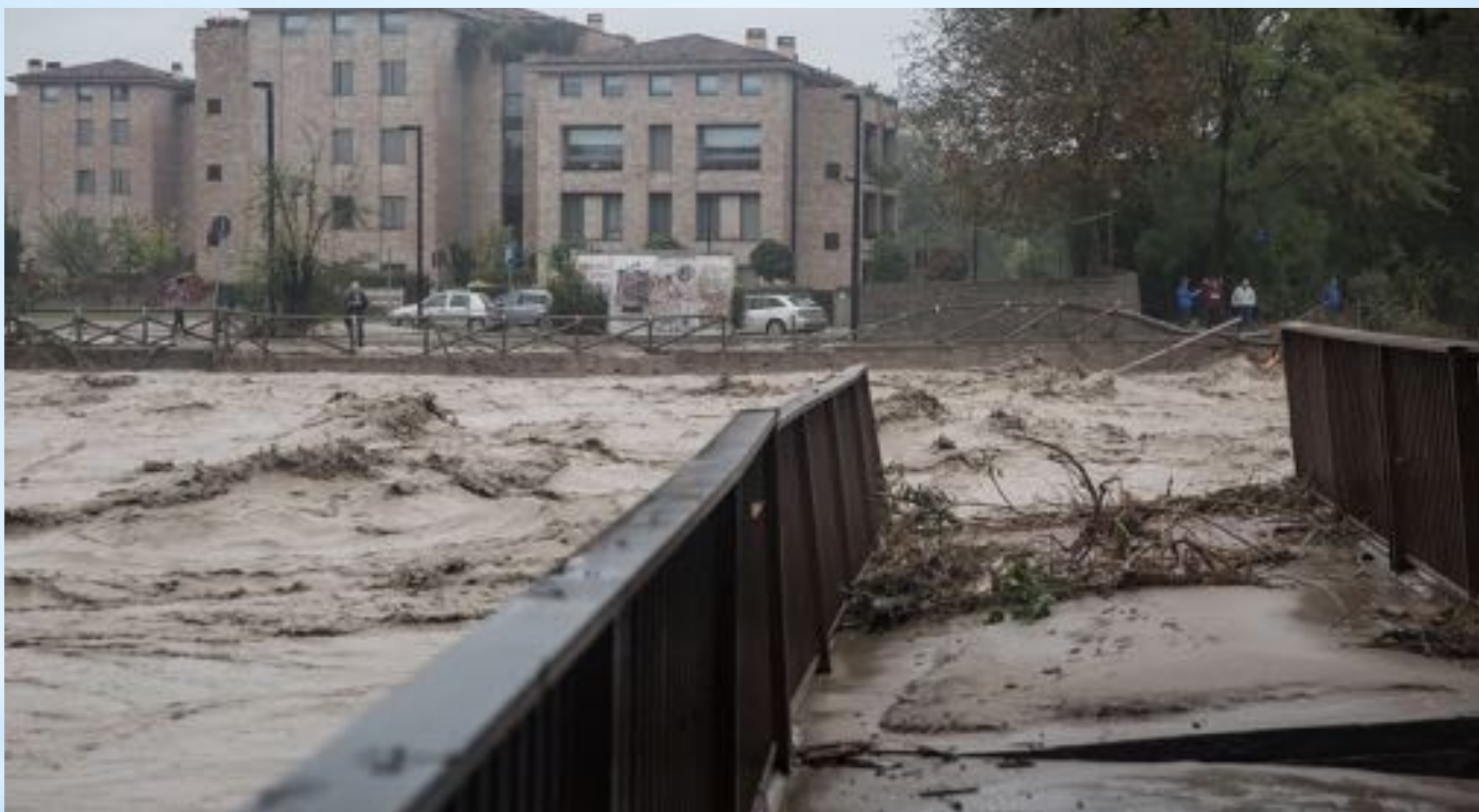
Il ponte della Navetta crollato (Da Stefano Castagnetti)
